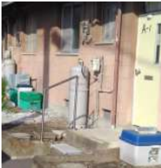
市営住宅玄関前の階段横に設置された金属製の手すり
